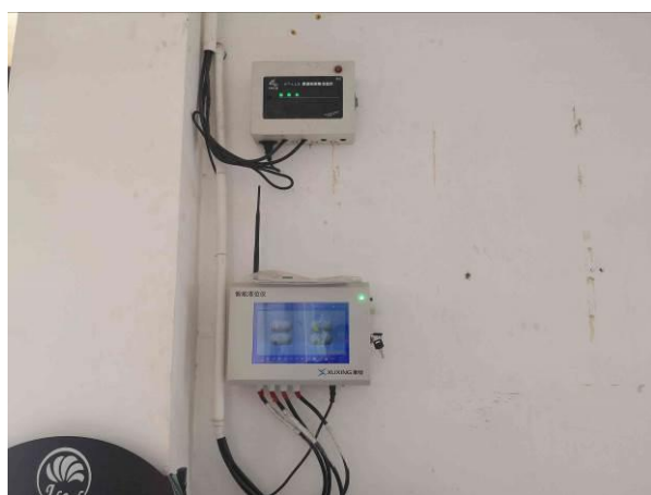
图 2-22 加油储罐防渗漏和液位报警仪
