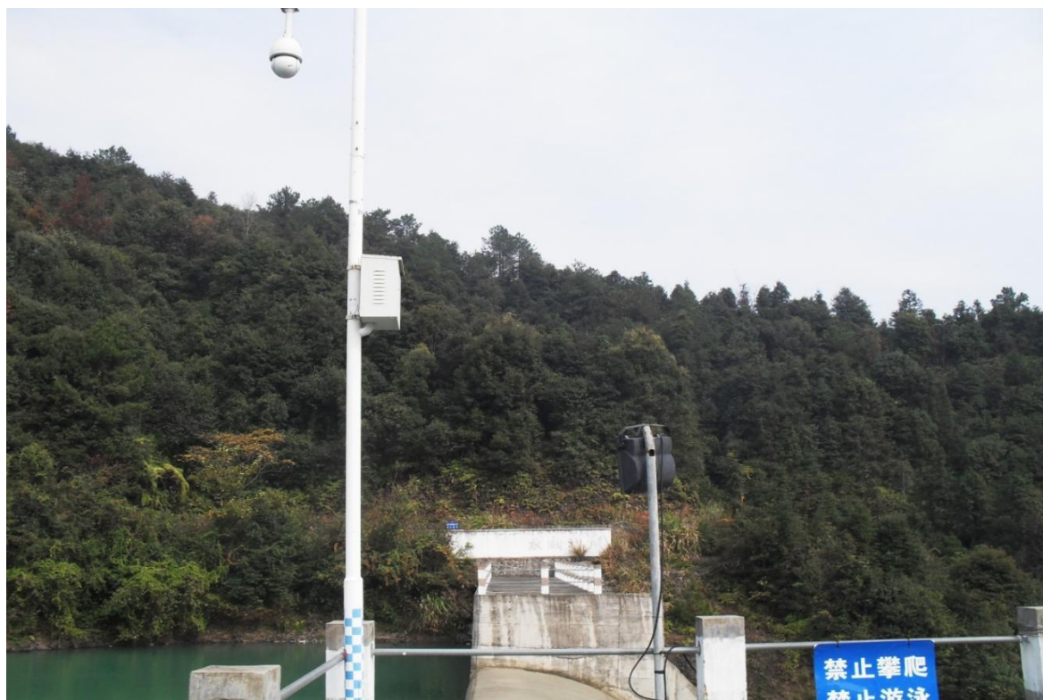
尾矿库在线监控设施（监控探头）
